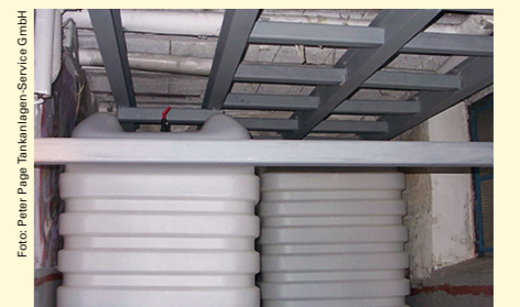
Heizöltankanlage mit Auftriebsicherung
